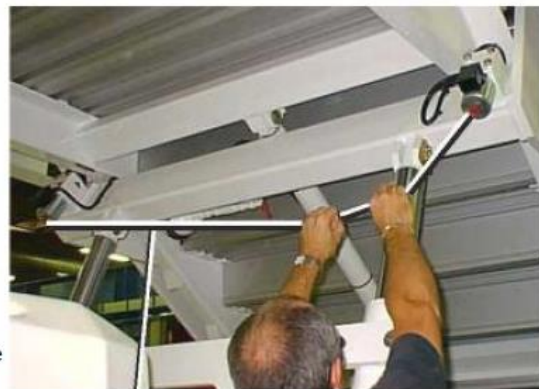
Câble de secours
